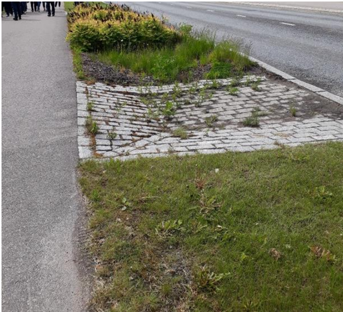
Kuva 19. Esimerkkikuva biosuodatusalueesta, jossa hulevedet johdetaan tiealueelta pintaa pitkin kiintoaineen laskeutukseen ja sen jälkeen biosuodatukseen (AFRY Finland Oy)
